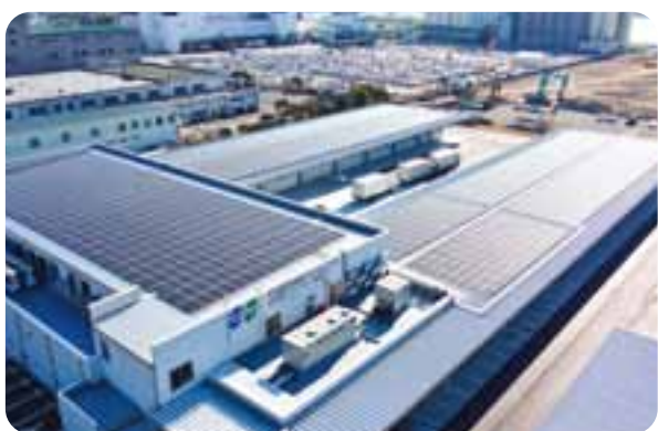
協同購入センター東神戸の屋上の太陽光パネル
